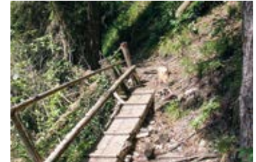
Schadhafte bauliche Vorrichtungen, welche ihre Schutzfunktion nicht mehr erfüllen, sind zu reparieren.
